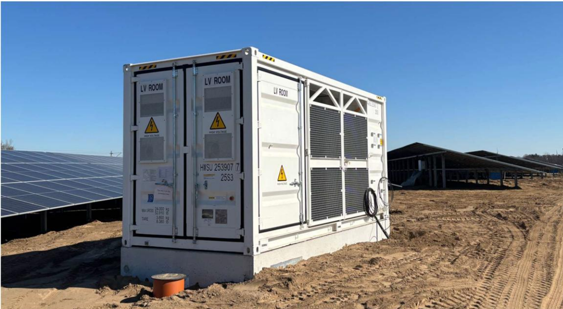
Abbildung 5: Objektbeispiel – Auf Acker errichtete Transformatorstation vor Einbringung der Begrünung
